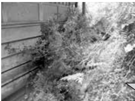
▲法面が崩落して、家屋まで土砂が迫っています
