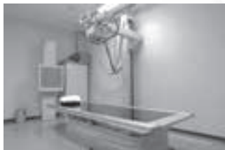
レントゲン室
