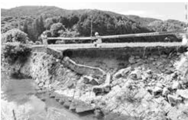
大雨により被災した護岸
