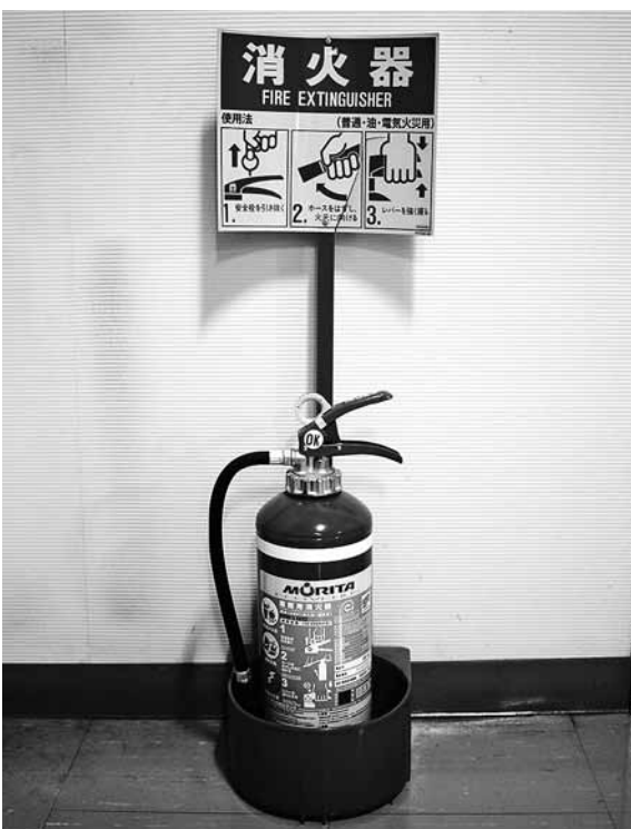
公共施設に設置している消火器
