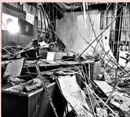
被災した益城町の議場
