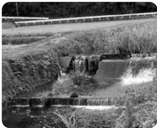
破損した井堰
