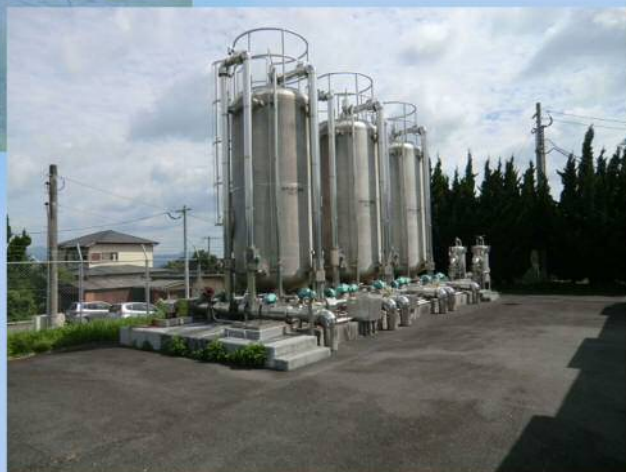
豊津浄水場 活性炭ろ過機
