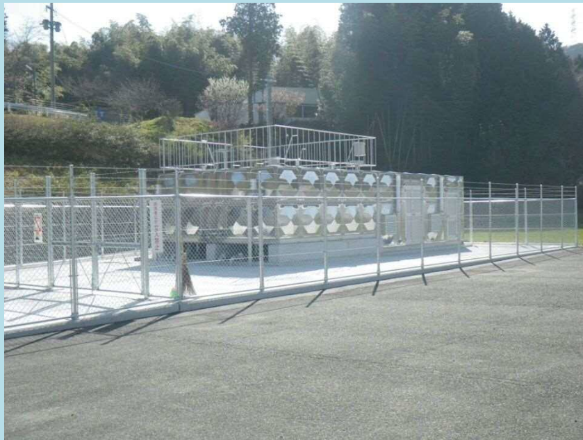
（宮原ポンプ場）
