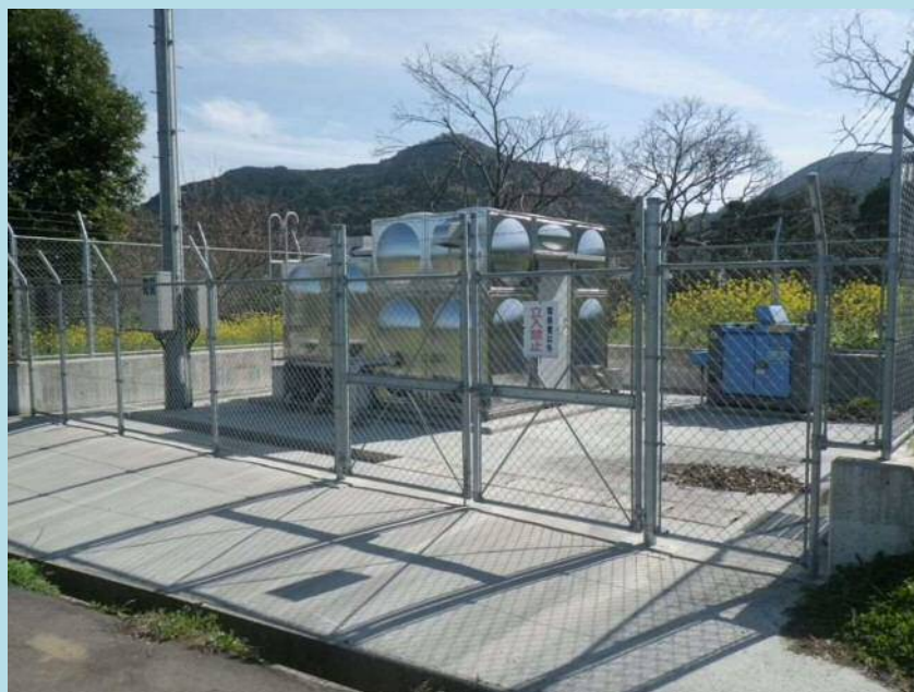
(御手水ポンプ場)
