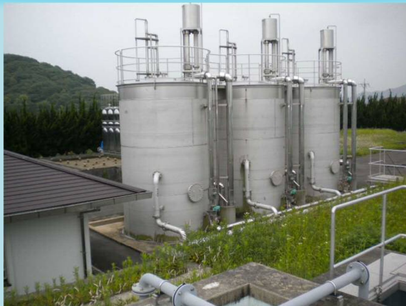
(豊津浄水場・急速ろ過機)
