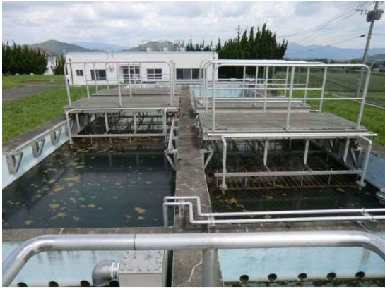
写真 3-3 豊津浄水場 供用開始：昭和53年度
