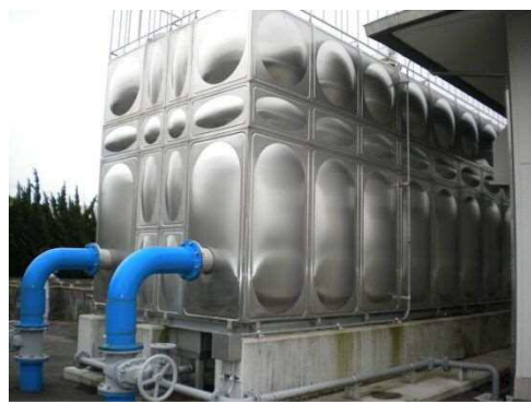
写真 3-2 豊津浄水場・受水槽
