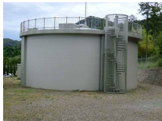
写真 3-8 勝山配水池 (1号) 容量 V = 650\text{m}^3/\text{日} 完成年度：平成 19 年度
